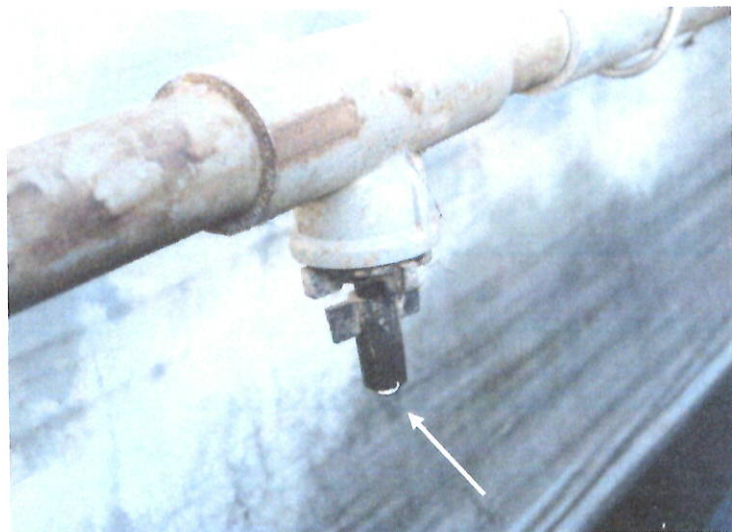
元栓異常 元栓から水滴が滴る
